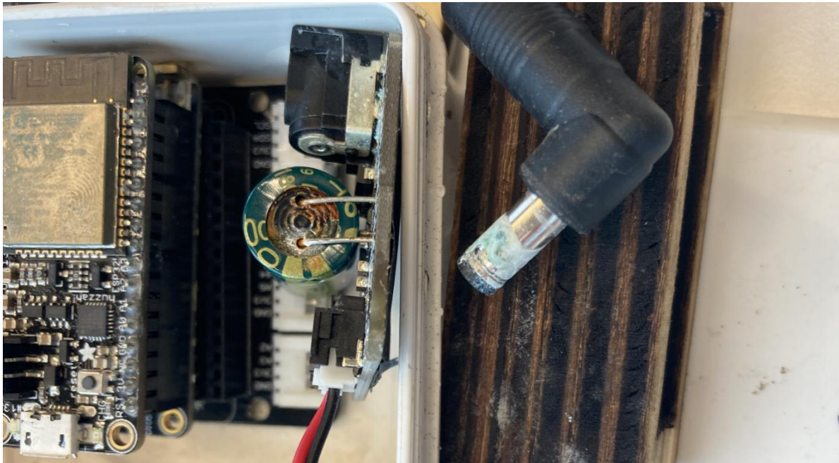
Abbildung 60 Korrodierte Elektronik eines PAX Counter
